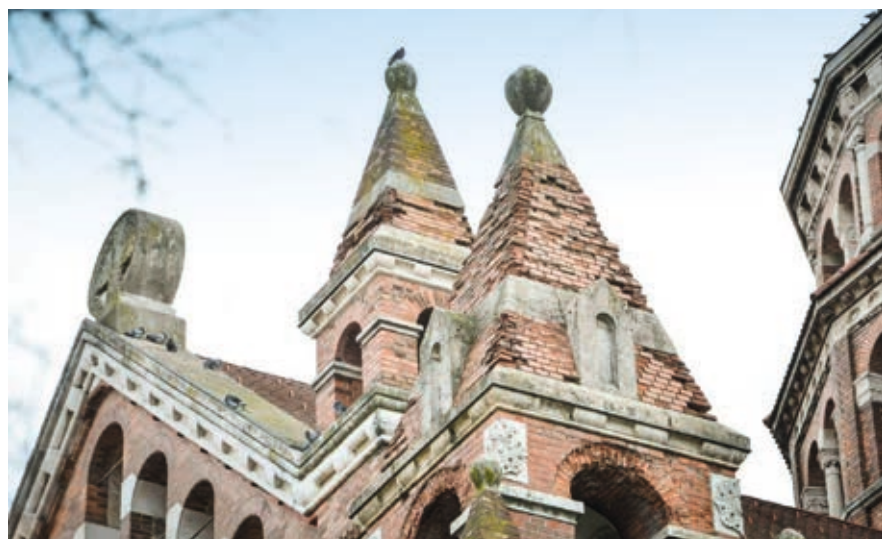
Az idő vasfoga a szegedi székesegyház külső burkolatát is alaposan kikezdte
